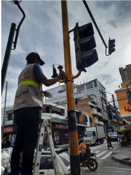
Antes - Efectos Vandalismo
